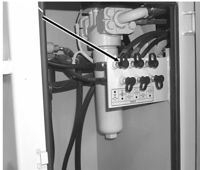
Рис. 5.68. Точка контроля давления масла в трансмиссии (в отсеке правого масляного бака)
