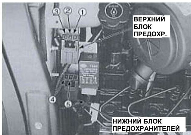
Рис. 71. Главные блоки предохранителей
